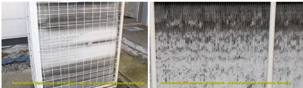
Abbildung 11: Luftwärmepumpe mit Vereisung: der Zwischenraum zwischen den Lamellen ist zu Beginn des Abtauvorgangs vollständig durch Eis verschlossen.
